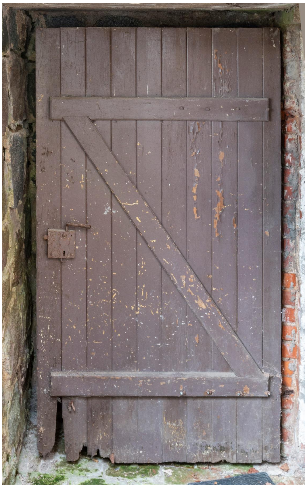
Fot. 4. Drzwi do piwnicy od strony wewnętrznej (zdjęcie wykonane po otwarciu). Powłoka malarska z wielu miejscach spękana i złuszczone, liczne uszkodzenia mechaniczne na powierzchni.
