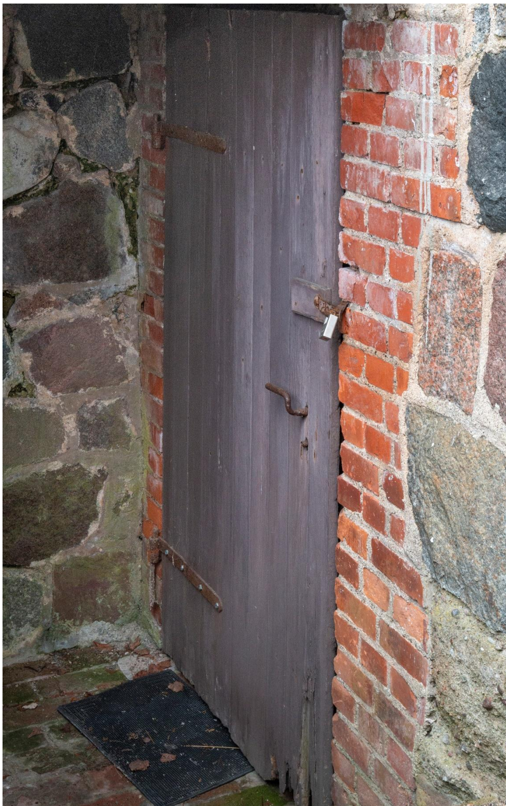
Fot. 1. Drzwi do piwnicy mają konstrukcję deskową, zamek puszkowy oraz zawiasy pasowe. Drewno jest silnie zdegradowane, stolarka powinna zostać wymieniona na nową o analogicznej konstrukcji. Zalecane byłoby przeniesie zamka do nowej stolarki, nawet jeśli zostanie wykonane dodatkowe, współczesne zamknięcie.
