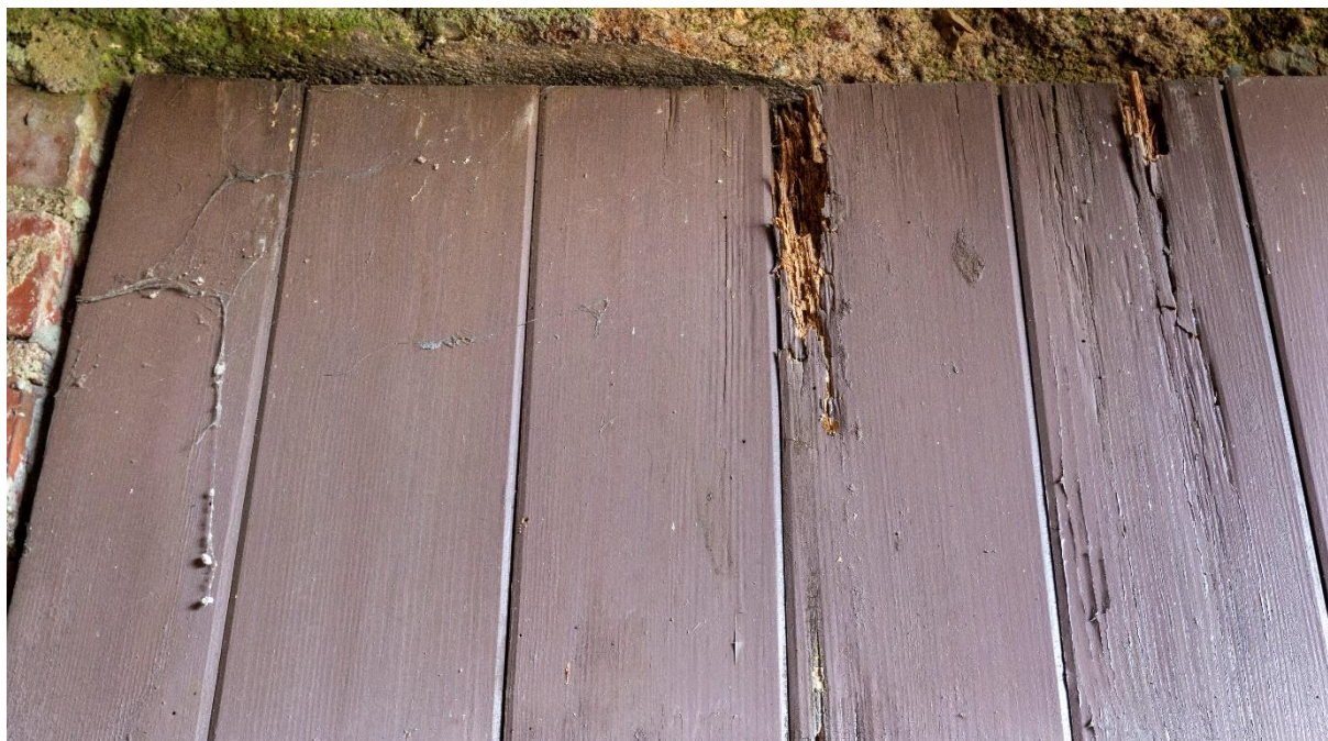
Fot. 2. Górna część skrzydła drzwi do piwnicy.
