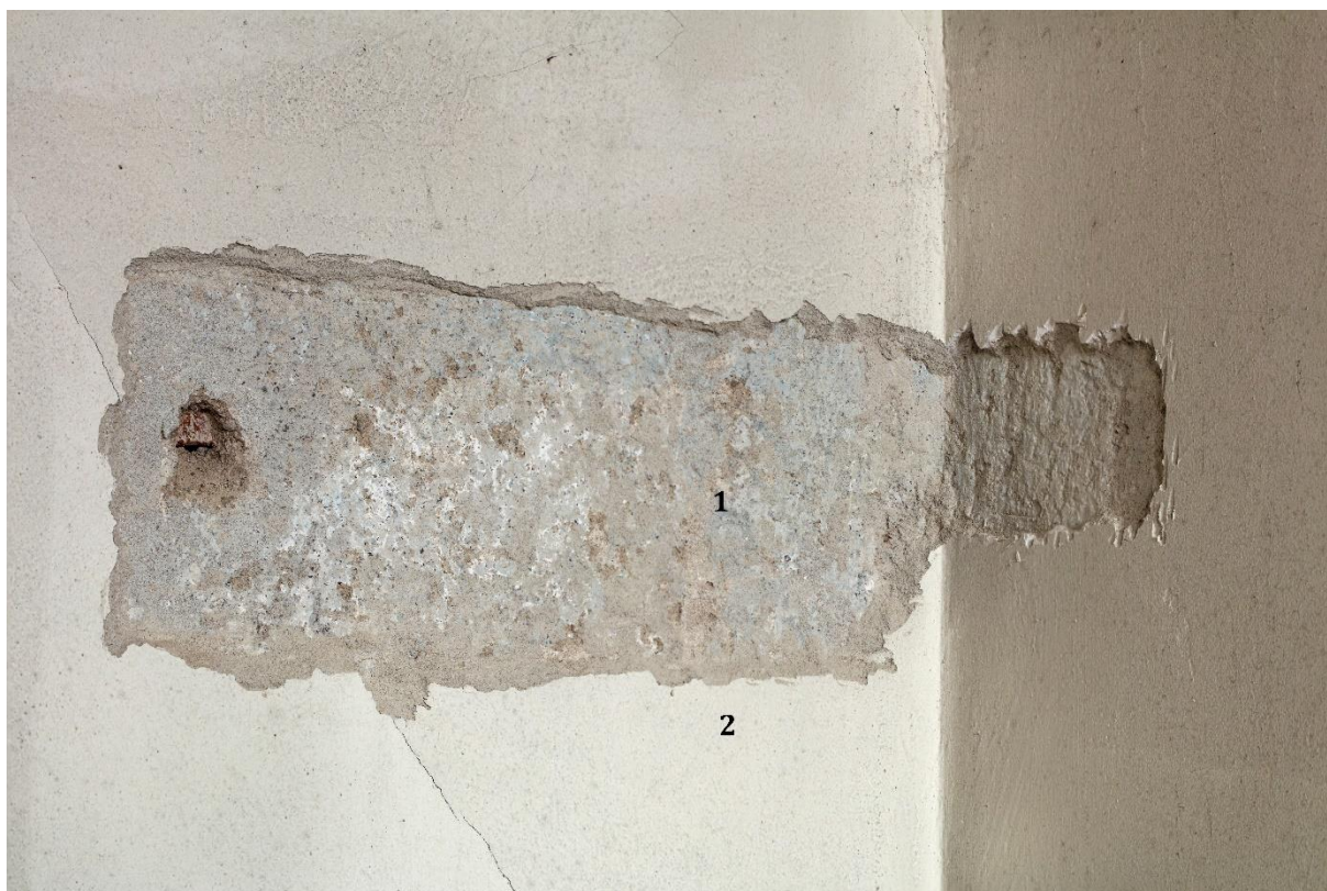
Fot. 13. Odkrywka nr 5 na ścianie północno-zachodniej (w lewej, północnej nawie, przy drzwiach). Pod warstwą współczesnego, zagładzonego tynku (2) widoczna wyprawa pierwotna, której nadano głębszą fakturę. Na pobiale warstwa malarska w odcieniu szaroniebieskim (1).
