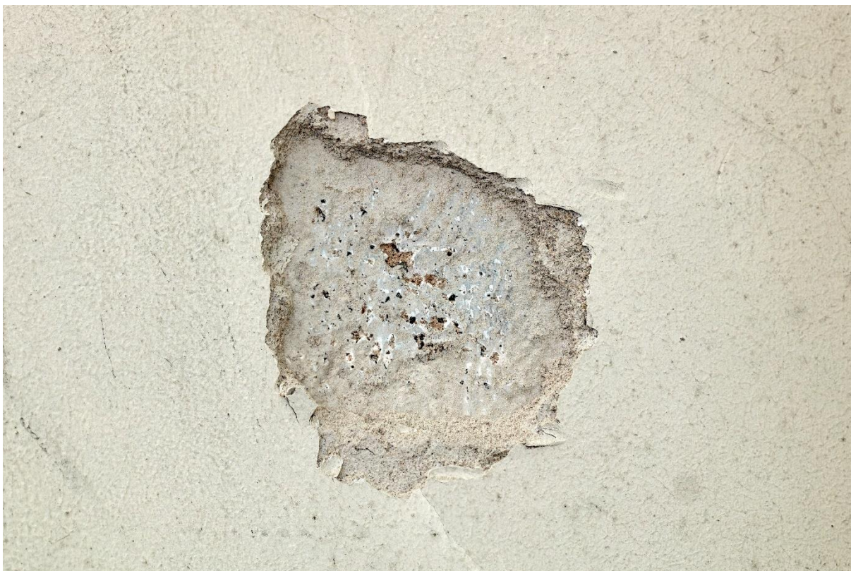
Fot. 19. Odkrywka nr 10 na ścianie w narożniku ścian południowo-zachodniej oraz północno-zachodniej (po lewej stronie wejścia). Pod widocznym obecnie, zagładzonym tynkiem tynk starszy, fakturalny z szaroniebieską warstwą malarską.
